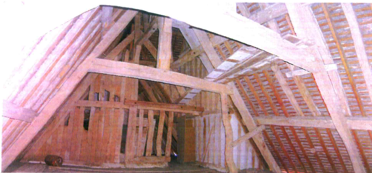
1. La charpente est formée de fermes avec pannes et arbalétriers, poinçon et entrain retroussé.
