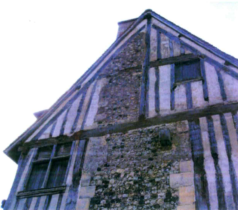
3. La croisée en bois située au premier niveau a été restituée lors de la précédente restauration.
