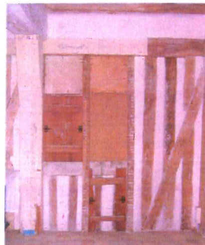
4 Croisée en bois donnant sur la galerie et obturée par des planches cloutées
